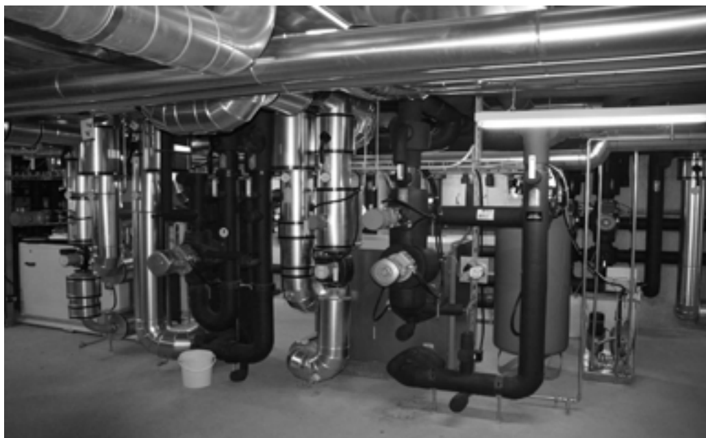
Une pompe à chaleur (PAC) eau-eau extrait la chaleur des eaux souterraines pour le transférer à un circuit de chauffage secondaire.
