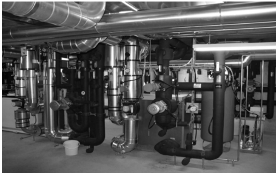
Bei einem GWWP-Betrieb wird einem Grundwasser die Wärme entzogen und an einen sekundären Heizkreislauf abgegeben.
